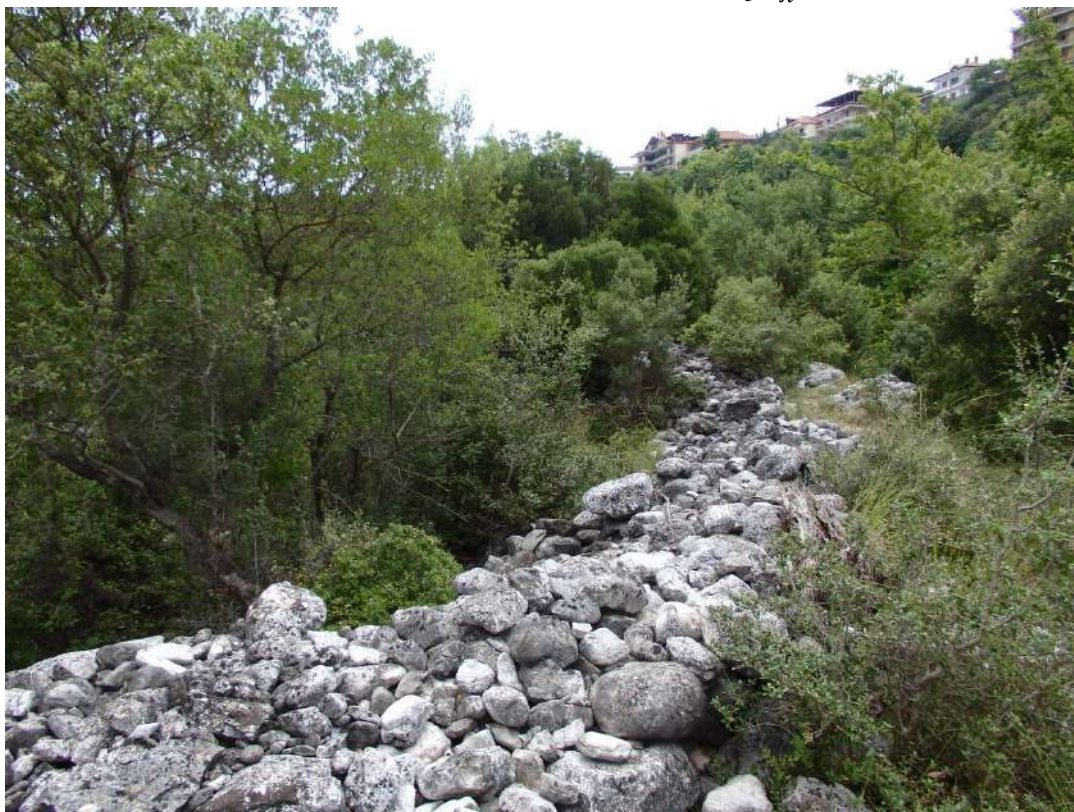
Φωτό 5: Κατεστραμμένη ξηρολιθοδομή κατά μήκος της ορειβατικής Διαδρομής 2 που χρήζει αναστήλωσης/ανακατασκευής.
