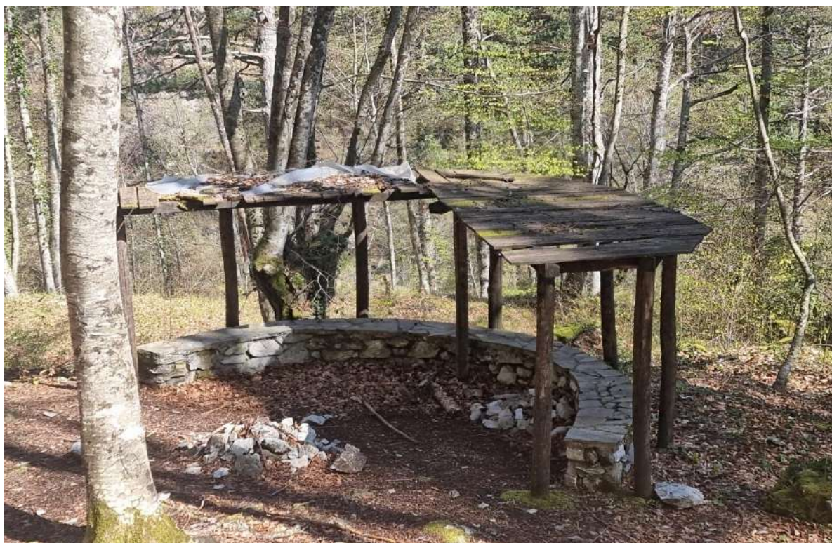
Φωτό 10: Το κατεστραμμένο ξύλινο στέγαστρο επί της Ορειβατικής Διαδρομής 1. Ο πέτρινος πάγκος θα διατηρηθεί ανέπαφος όντας σε καλή κατάσταση.
