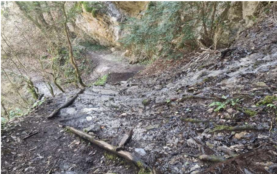
Φωτό 5: Υφιστάμενα ξύλινα σκαλοπάτια επί της Ορειβατικής Διαδρομής 1, τα οποία έχουν υποστεί ισχυρή διάβρωση και χρήζουν άμεσης αντικατάστασης.
