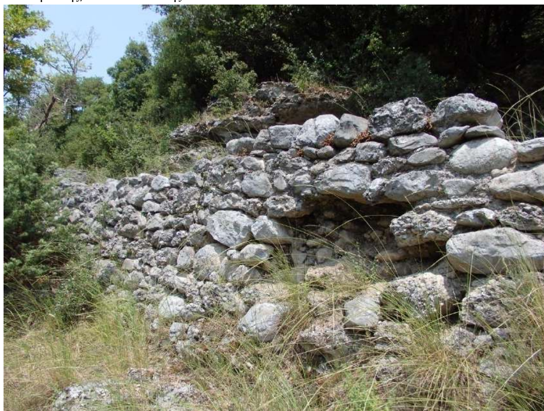
Φωτό 6: Η συγκεκριμένη ξηρολιθοδομή κατά μήκος του μονοπατιού διατηρείται σε σχετικά καλή κατάσταση, αλλά και εδώ οι εργασίες συντήρησής της είναι απαραίτητες για την εξάλειψη της επικινδυνότητάς της.
