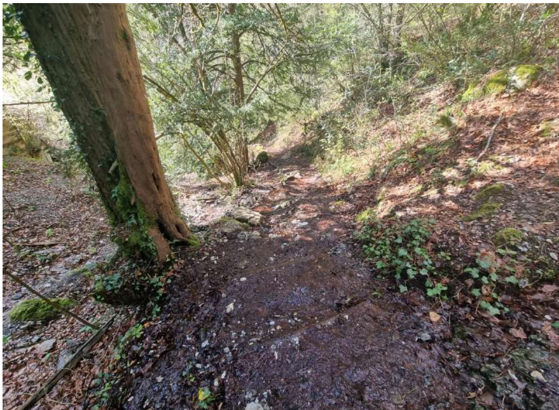
Φωτό 11: Το πρώτο τμήμα της Ορειβατικής Διαδρομής 1 μήκους 25 m, όπου η προσπέλαση/διάβαση του μονοπατιού χρήζει αποκατάστασης. Η επίδραση των απορρεόντων υδάτων είναι ιδιαίτερα εμφανής
